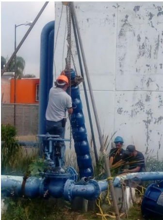
SUMINISTRO, INSTALACIÓN Y PUESTA EN MARCHA DEL EQUIPO DE BOMBEO EN EL REBOMBEO MISIÓN DEL VALLE, PARA EL MEJORAMIENTO EN LA EFICIENCIA ELECTROMECÁNICA
